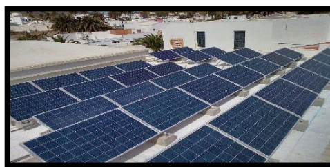
Instalación de Plantas fotovoltaicas gestionadas por el Consorcio del Agua del Cabildo de Lanzarote
